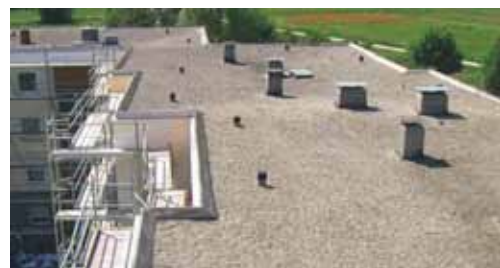
Частое явление: на крышах из битума, посыпанным гравием, вентиляторы и каминные трубы затрудняют доступ к полу пространству, куда задувается изоляция
